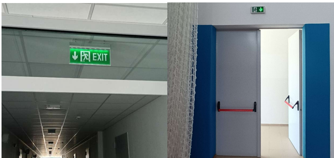
Slika 5.1. Protupanična rasvjeta u hodniku zgrade i na izlazu iz sportske dvorane
