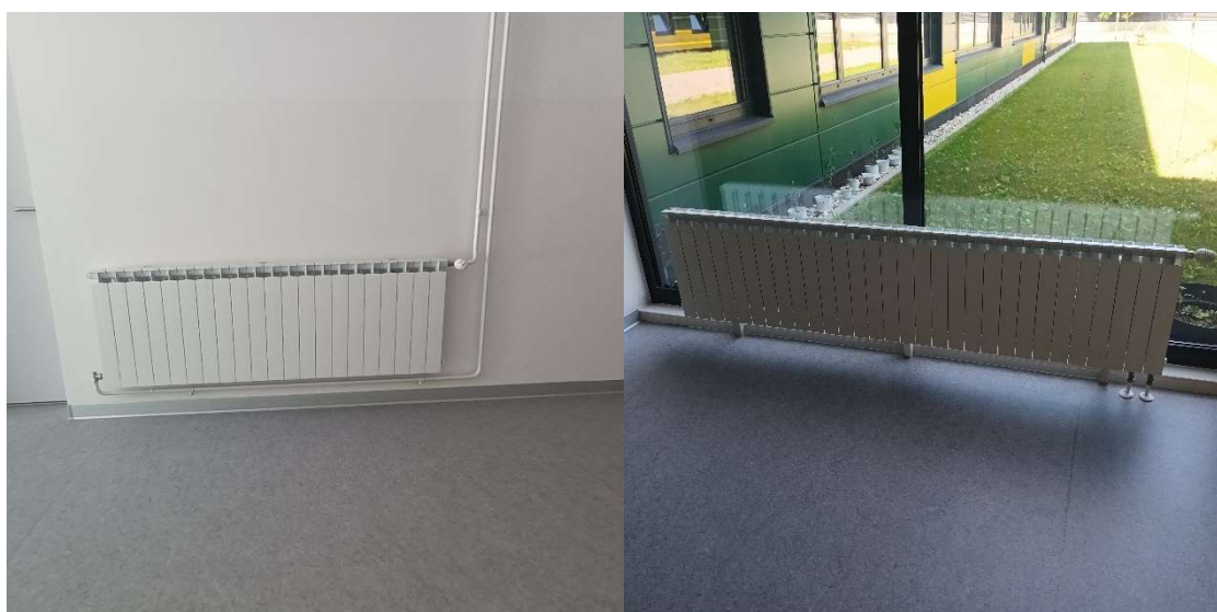
Slika 4.7. Radijatori u zgradi
