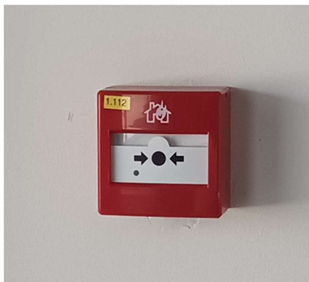
Slika 5.2. Protupožarno tipkalo postavljeno u vjetrobranu zgrade
