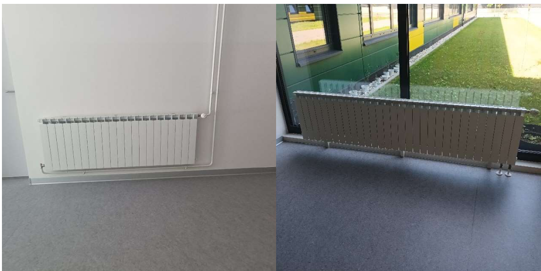
Slika 4.7. Radijatori u zgradi
