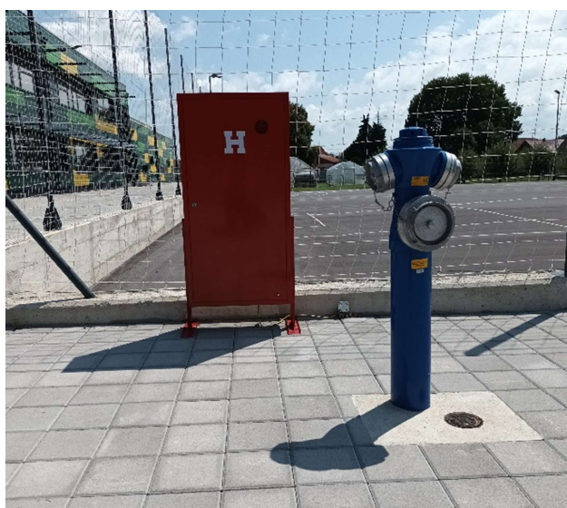
Slika 5.3. Vanjski hidrant s jugozapadne strane zgrade
