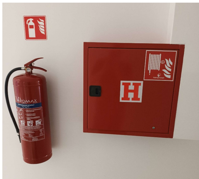
Slika 4.6. Zidni hidrant i aparat za gašenje požara u hodniku zgrade
