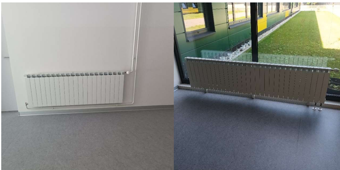
Slika 4.7. Radijatori u zgradi
