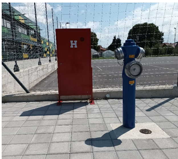
Slika 5.3. Vanjski hidrant s jugozapadne strane zgrade
